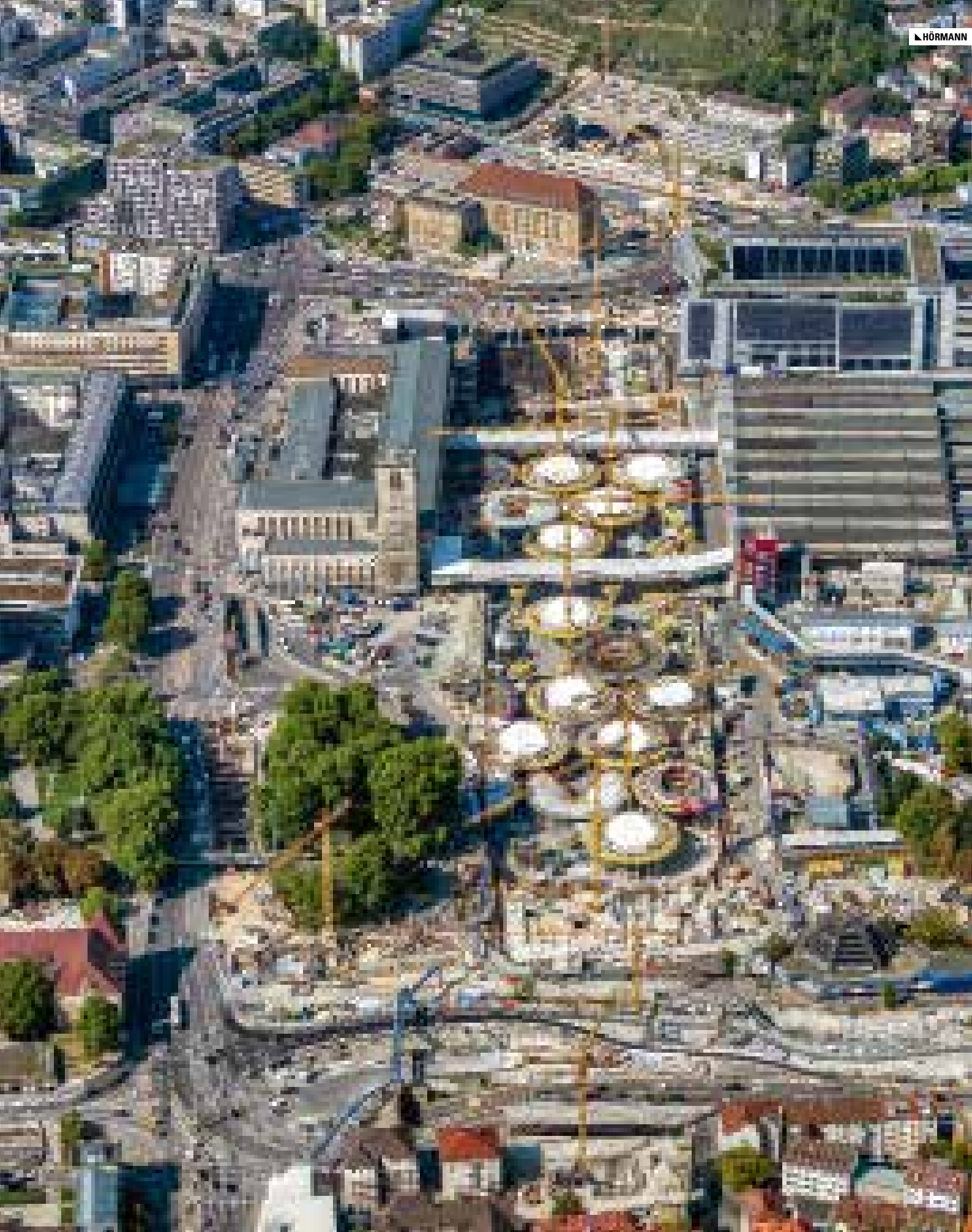
Aufwendig und umstritten: Der Neubau des Stuttgarter Hauptbahnhofs wird größtenteils unterirdisch errichtet.
